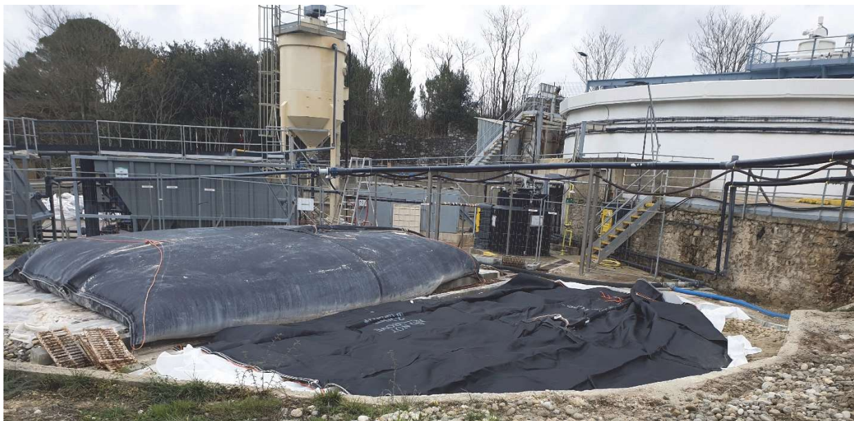
Illustration 114 : Vue de la station de dépollution de la Combe-du-Saut. Géotubes en cours de remplissage au premier plan - Limousis (11).
