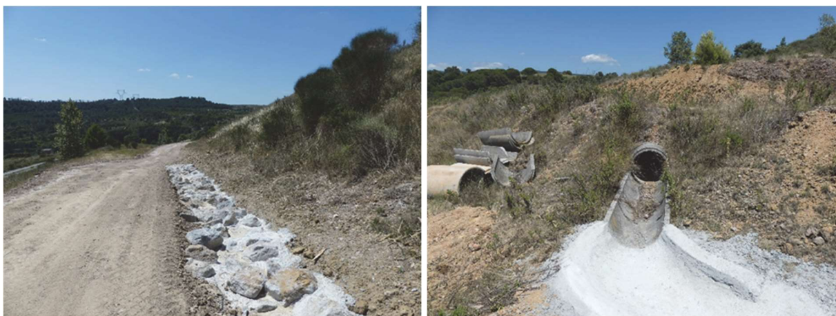
Illustration 7 : Exemple de travaux de reprises de désordres observés sur l'Artus : reprise de ravinement sur piste (à gauche), reprise d'un caniveau d'écoulement des eaux de ruissellement (à droite) (juillet 2022).
