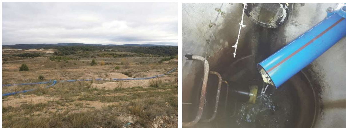
Illustration 46 : Jonction en mai 2021 des deux nouvelles conduites des drains de Montredon en une canalisation unique et exutoire dans le regard (2021).
