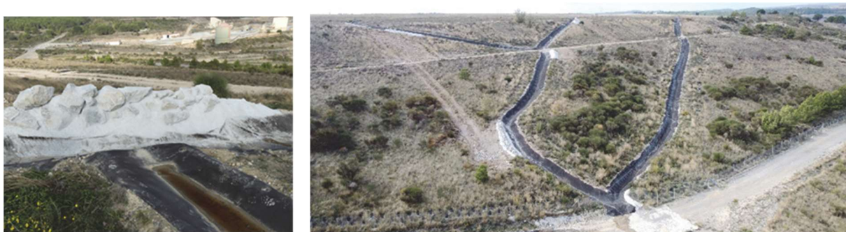
Illustration 29 : Travaux de confortement des descentes d'eau pour éviter une surverse et érosion en cas de forte pluie (à droite, prise de vue drone).
