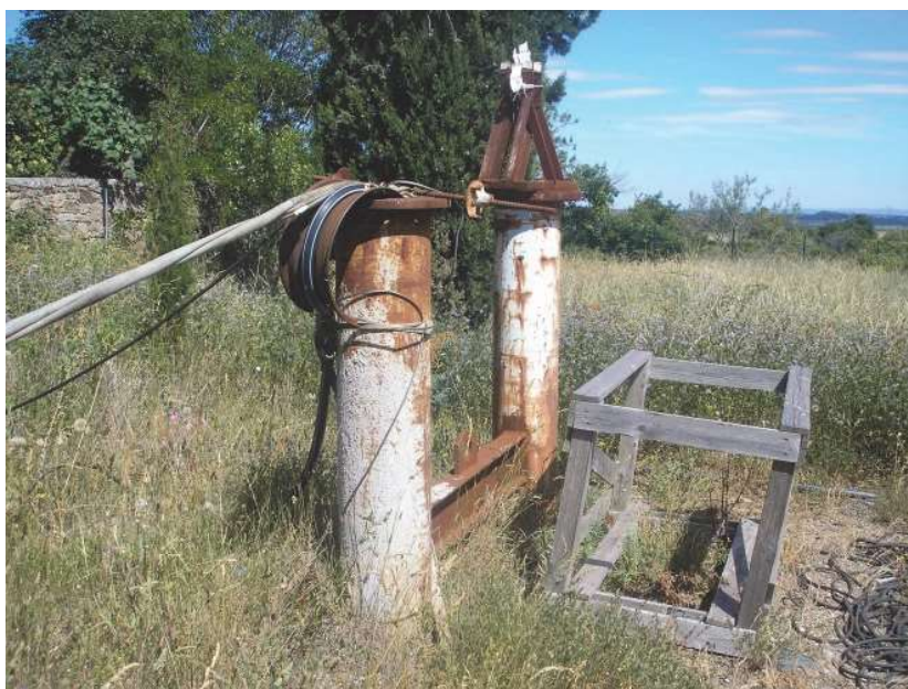
Illustration 157 : Cheminée Panneau Sud (©MINELIS, 2018).
