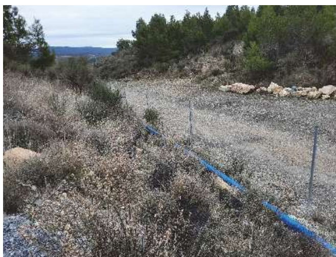
Illustration 30 : Photographies de la canalisation de Montredon positionnée à l'intérieur de la clôture (novembre 2022).
