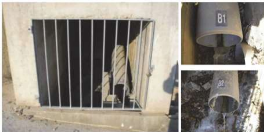
Illustration 85 : Arrivée des drains B1 et B2 à la station de dépollution (©MINELIS, 2020).
